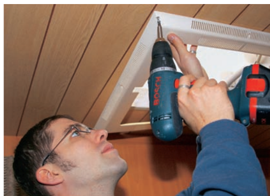
2 Völlig losgelöst: Die Schrauben des Dachluken-Rahmens lassen sich bequem mit einem Schrauber entfernen.
